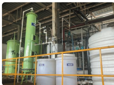
水処理設備(NNMI・インド) 二層ろ過および逆浸透膜処理により、排水の再利用と水資源負荷の低減を推進
