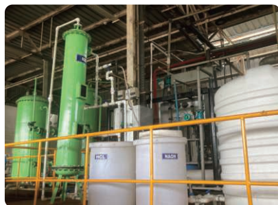
二層ろ過水処理施設タンクと逆浸透膜処理施設 (NNMI・インド)
