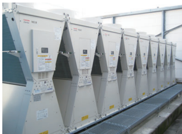
桑名製作所 小中型工場「熱源発生ユニット」
