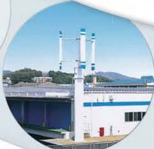
輸出センター(桑名)の風力発電機 発電量:17MWh/年 CO 2 削減量:約8トン/年
