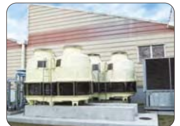
岡山製作所のコンプレッサ用水冷チラー
