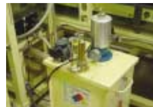
新型防錆油の給油装置
