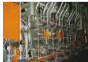
燃料転換を行った熱処理炉
