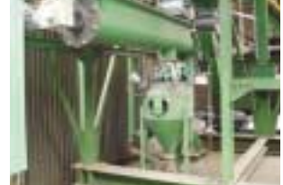
廃砂の空気圧送装置
