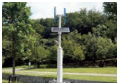
桑名市内の公園に設置した 「ハイブリッド街路灯」
