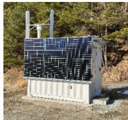
循環式水洗トイレを搭載したエコトイレ
